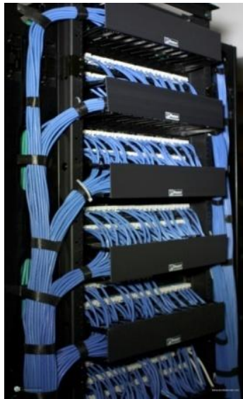
Rajah 3 : Penyusunan dan penyambungan kabel pada server
