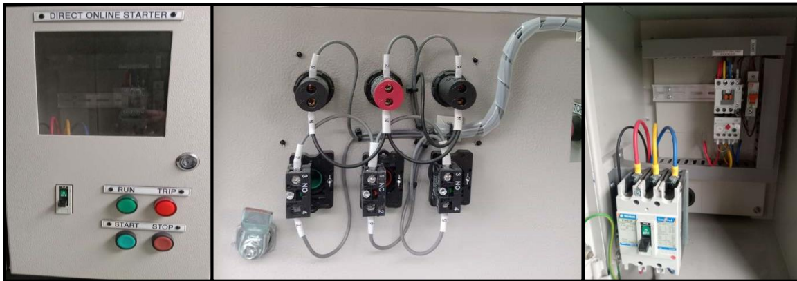
Rajah 9: Contoh Penggunaan Auto Cable Pada Panel Kawalan Motor
